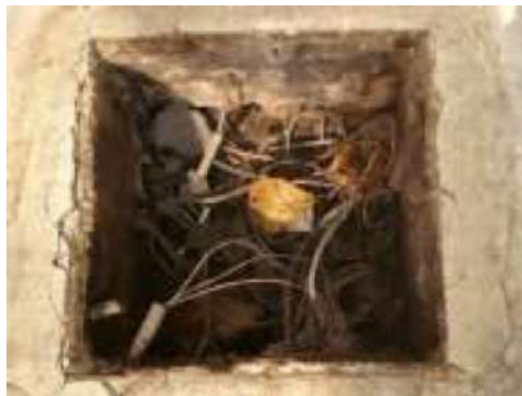
Figura 2: Vazamento de combustível próximo à condutores elétricos.
