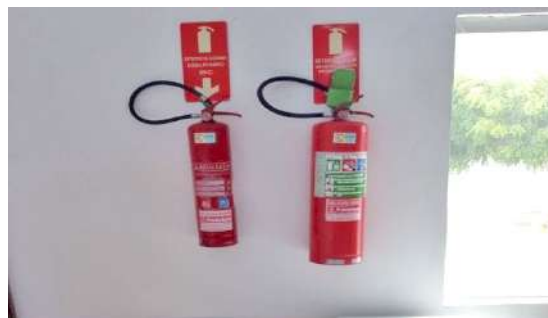
Figura 9 – Extintores de incêndio com obstáculos
