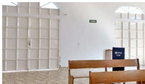
Figura 7 – Sinalização de Saída (b)
