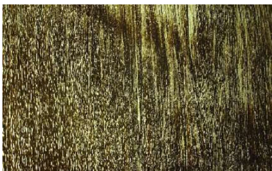
Figura 1 – Parede interna do tanque antes da limpeza
