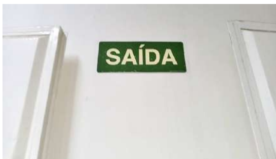
Figura 6 – Sinalização de Saída (a)
