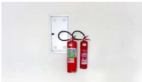
Figura 8 – Extintores de incêndio sem marcação
