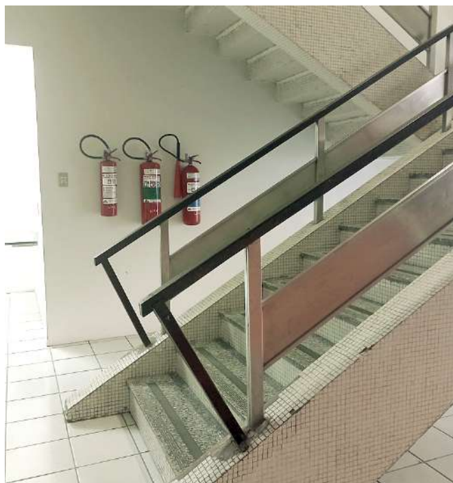
Figura 2 - Unidades extintoras com sinalização vertical e horizontal ausentes, instaladas em local de difícil visualização e acesso.
